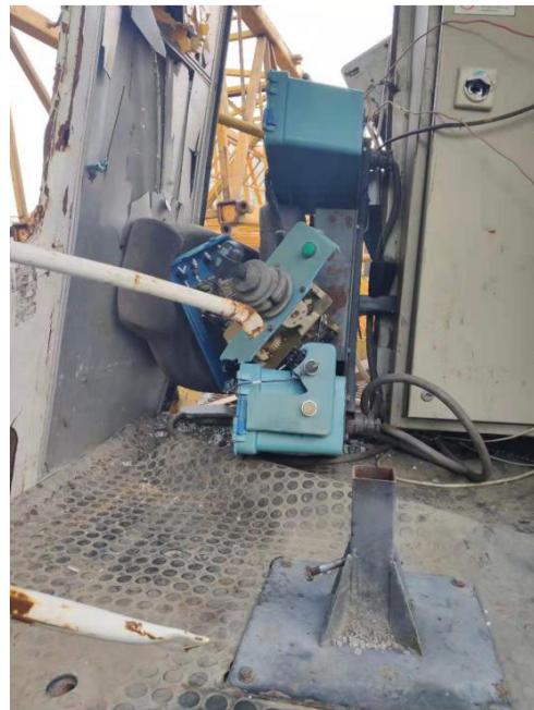
图6 损坏的司机室
